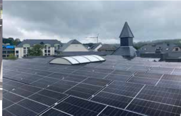
Gemeindeverwaltung Weismes: Anlage mit 44,8 kWp
