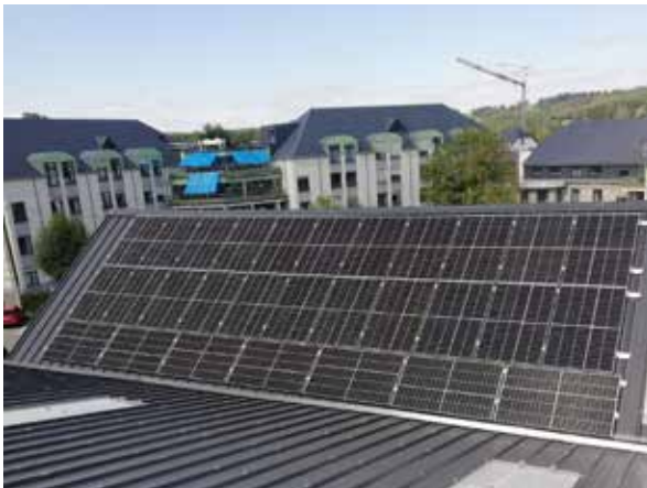
Bauhof der Gemeinde Weismes: Anlage mit 40 kWp
