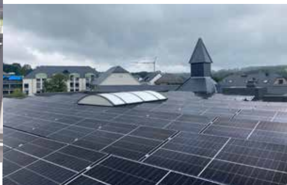
Administration Communale de Waimès : installation de 44,8 kWc
