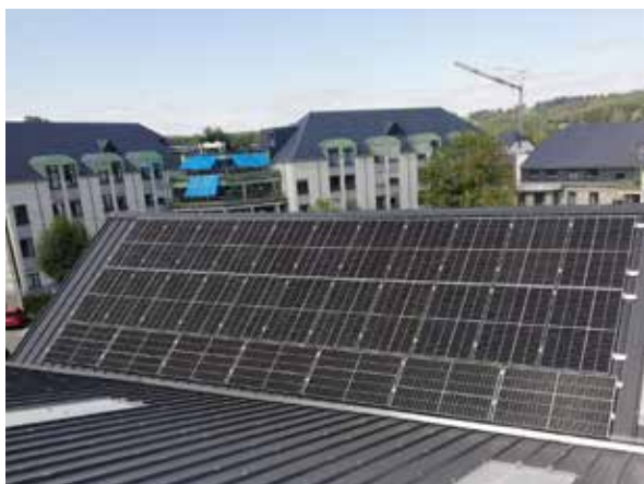
Ateliers Communaux de Waimès : installation de 40 kWc
