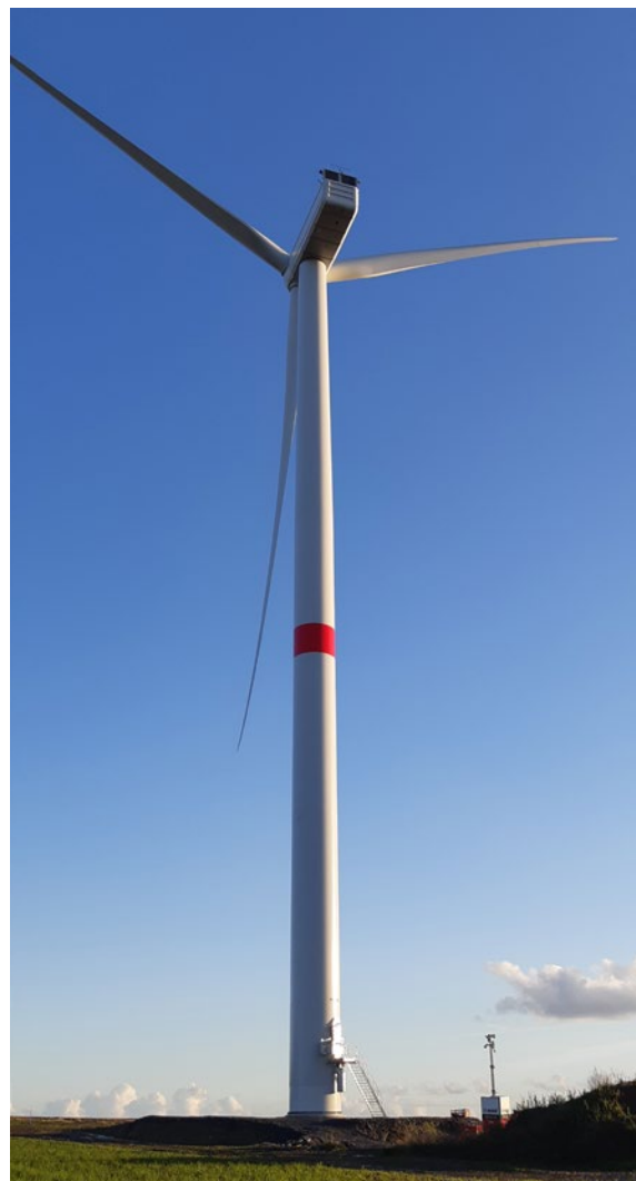
Die neue Windkraftanlage in Gaurain-Ramecroix befindet sich entlang einer Autobahn
