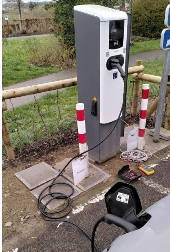
Die neue Ladestation in St. Vith
